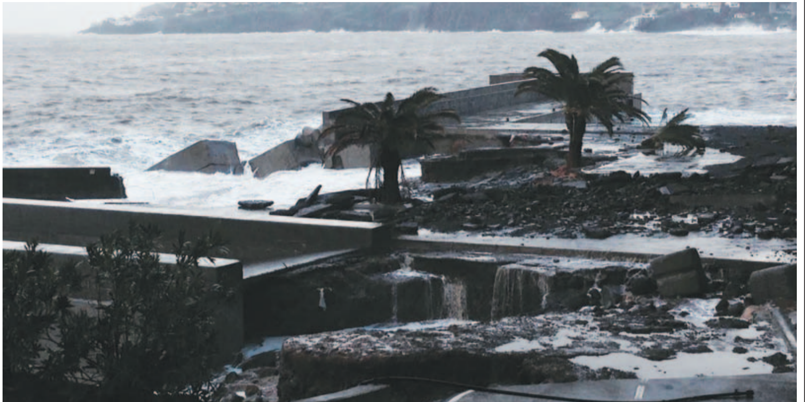
O porto de abrigo de Santa Cruz, localizado por debaixo da cabeceira da pista ao Aeroporto da Madeira, ficou completamente destruído. FOTO DR
