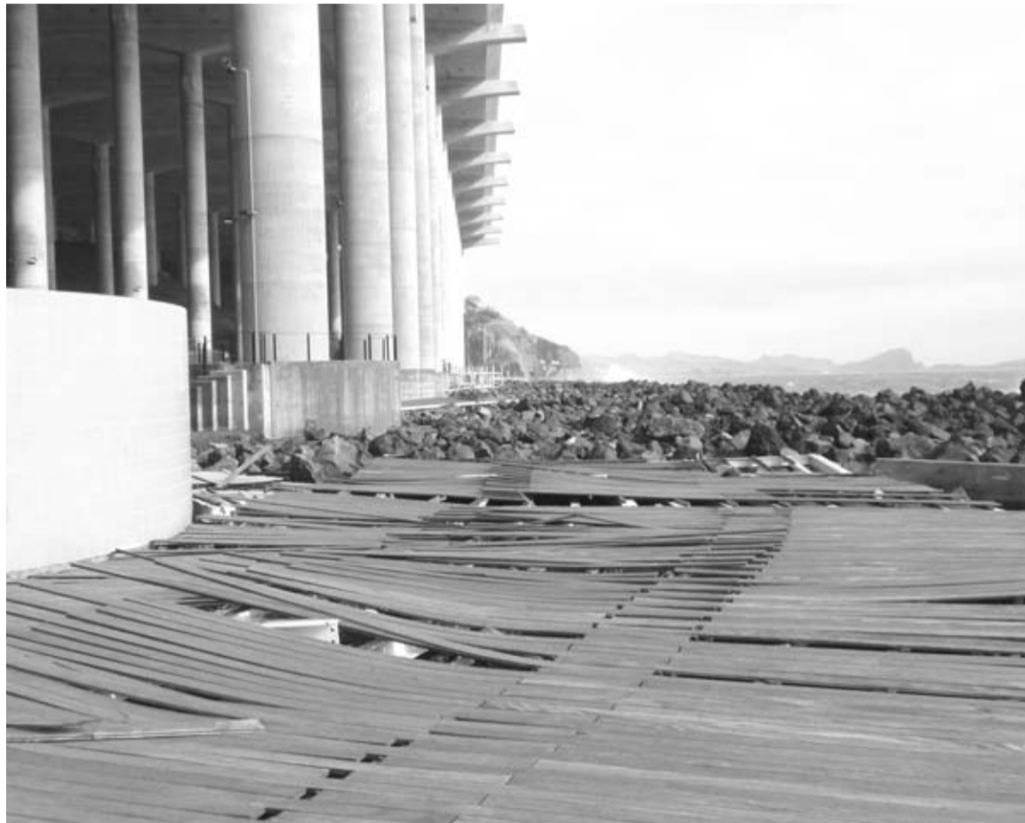
O passadiço de Água de Pena ficou neste estado.
