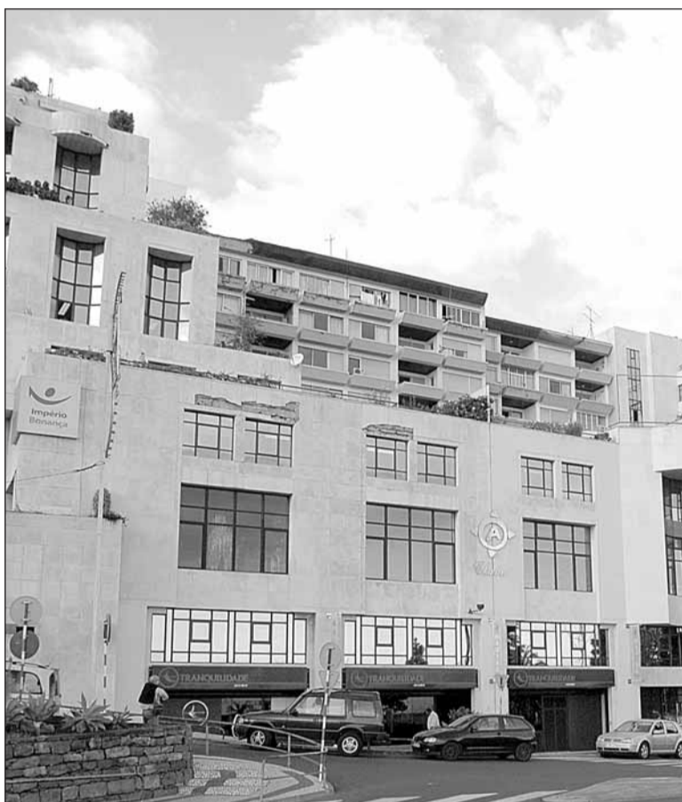
A queda de material desta fachada põe em risco quem passa na via pública.
