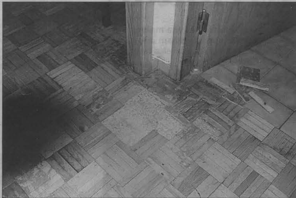
Nem os azulejos se aguentam, nem os tacos ficam no lugar onde foram colocados.
