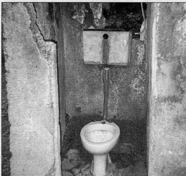
O estado em que se encontrava a casa de banho.
