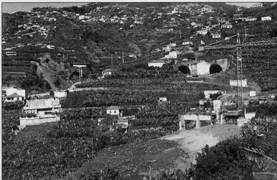
Até Setembro do próximo ano, estará concluída a via rápida Câmara de Lobos/Ribeira Brava.
