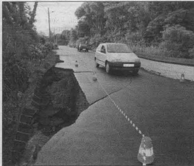
A ponte de acesso a Espalhafatos ficou muito danificada e deverá ser encerrada.
