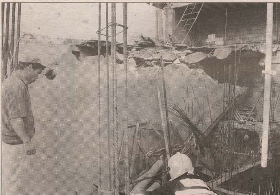
A laje que se abateu inesperadamente, atingindo só de "raspão" os três operários sob a qual trabalhavam.
