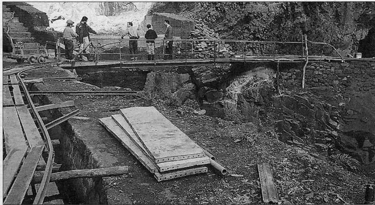
Uma aberta a separar o túnel "1" do "2". O temporal de Outubro arrastou tudo. Foi preciso construir uma pequena ponte de ligação.
