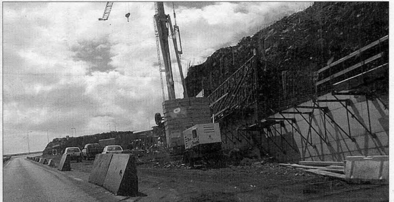
São estas as obras que têm sido alvo de críticas devido à projecção de pedras.
