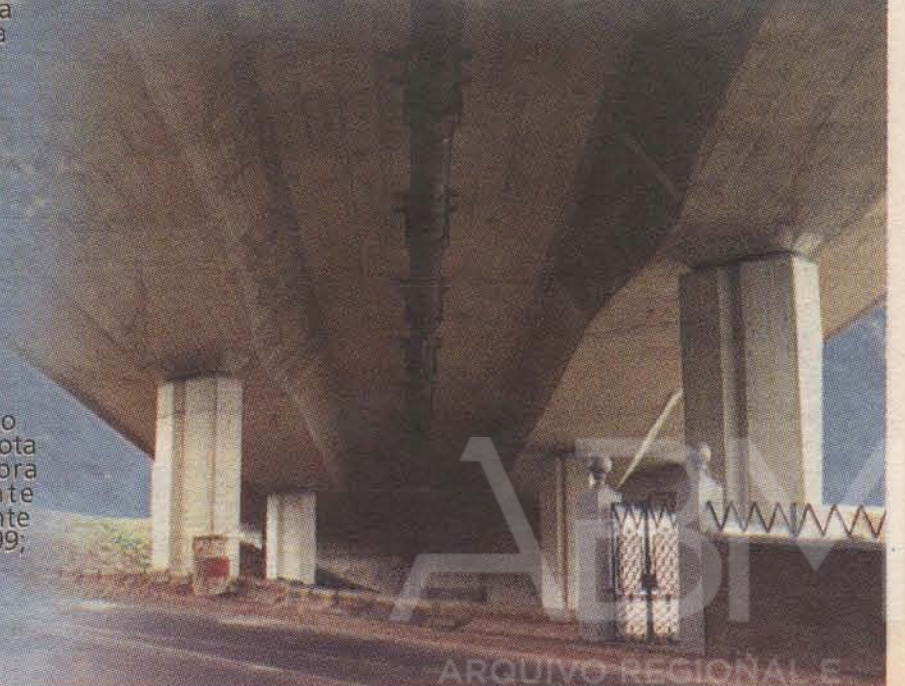
CONDUTA DA COTA 200
