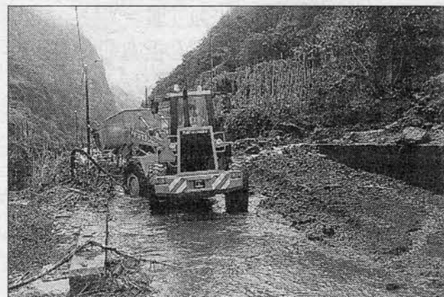
A derrocada obstruiu completamente a estrada.
