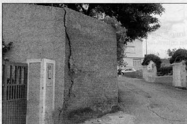
O muro que ameaça cair.
