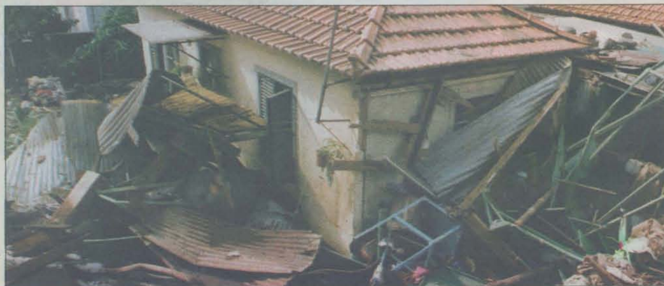
O temporal provocou danos avultados em diversas casas. A zona da ribeira de João Gomes foi muito afectada
