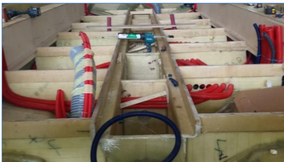
Figura 19 - Condutas elétricas da embarcação
