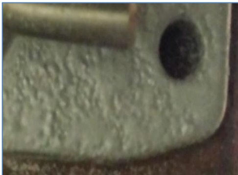
Figura 26 - Corrosão galvânica nas partes não submersas
