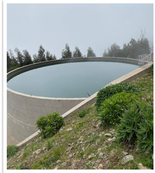
Figura 3 - Reservatório com capacidade para armazenar até 1 500 m 3 de água.
