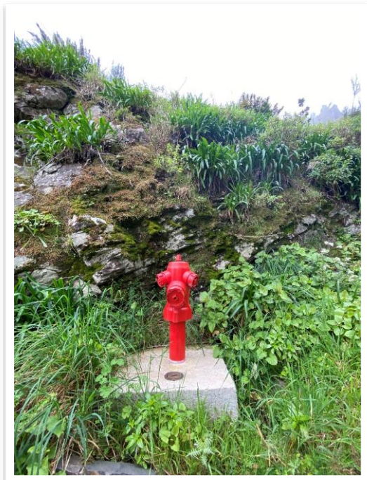
Figura 5 - Marco de incêndio, colocado a cada 500 metros.
