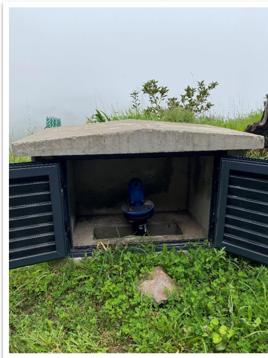
Figura 7 - Caixa de válvulas redutora de pressão.
