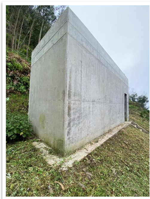
Figura 8 - Câmara de perda de carga.
